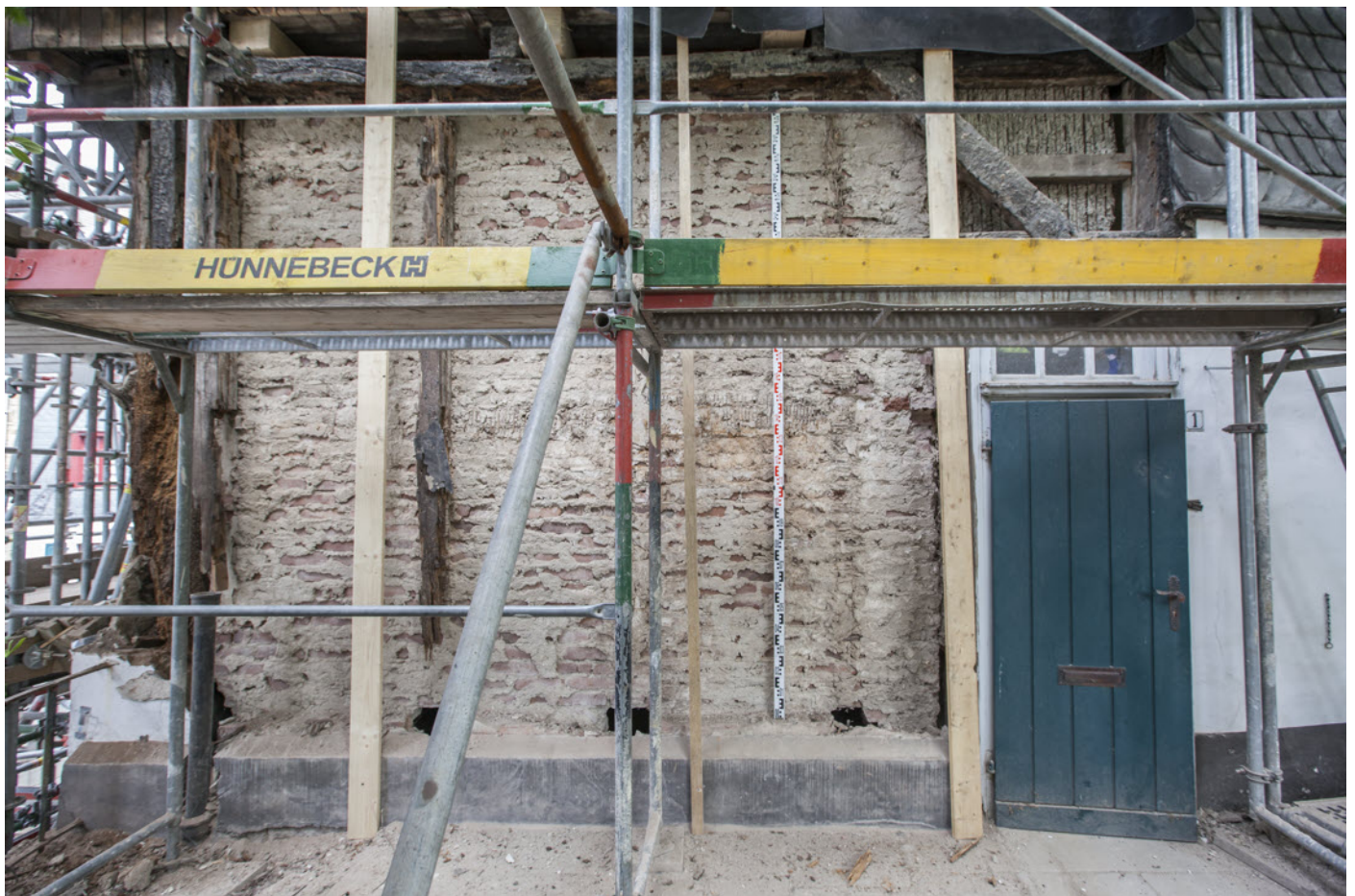
Abb. 25 Südliche Giebelseite: Stark geschädigte Reste der ursprünglichen Konstruktion
